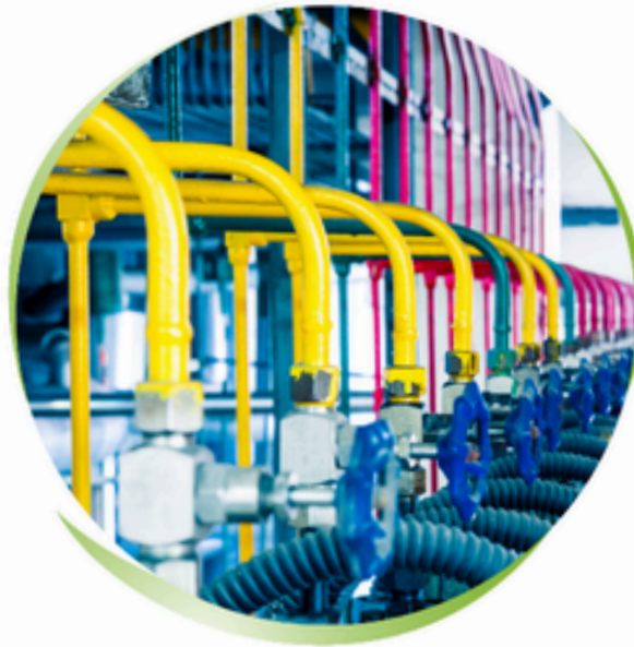
Gas pijplijn transport 30-70 bar
