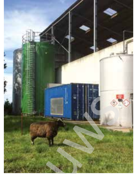
Installatie van Detricon voor de recuperatie van nutriënten uit mest.
