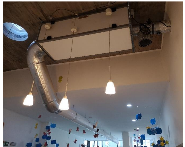
Afb.4. Geïnstalleerde ESP600 in 't Wonderkind
