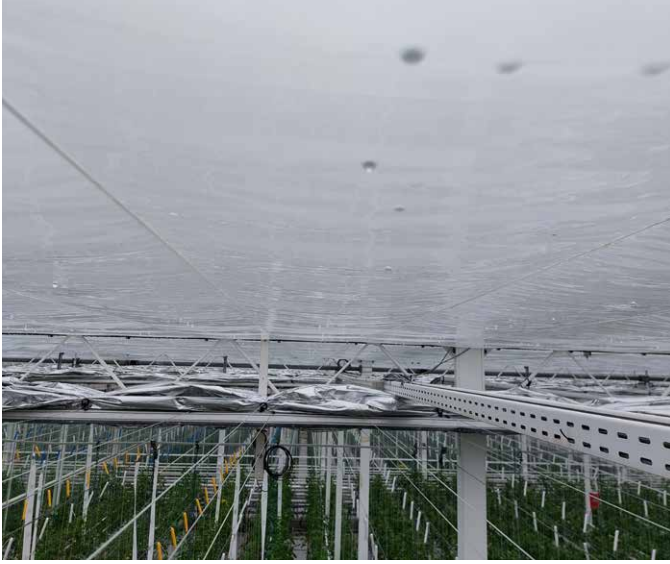
Op het PSKW installeerden we in tomaat boven het nachtscherm een AC-folie. Met een AC-coating vormt het vocht een waterfilm waardoor de lichttransmissie verhoogt en bovendien ook de isolerende eigenschappen van de folie verbeteren.
