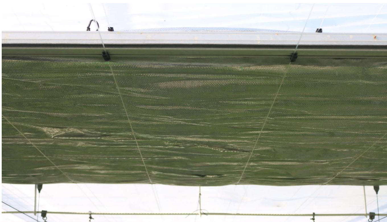
Figuur 1: Scherminstallatie Energik-afdeling 2024 op het Proefstation voor de Groenteteelt
