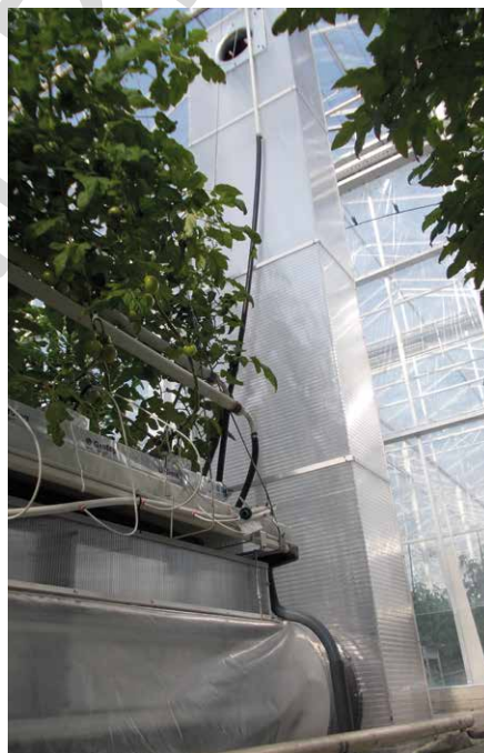
Op het PSKW wordt actieve ontvochtiging met behulp van een dampwarmtepomp en warmtemassawisselaar getest.
