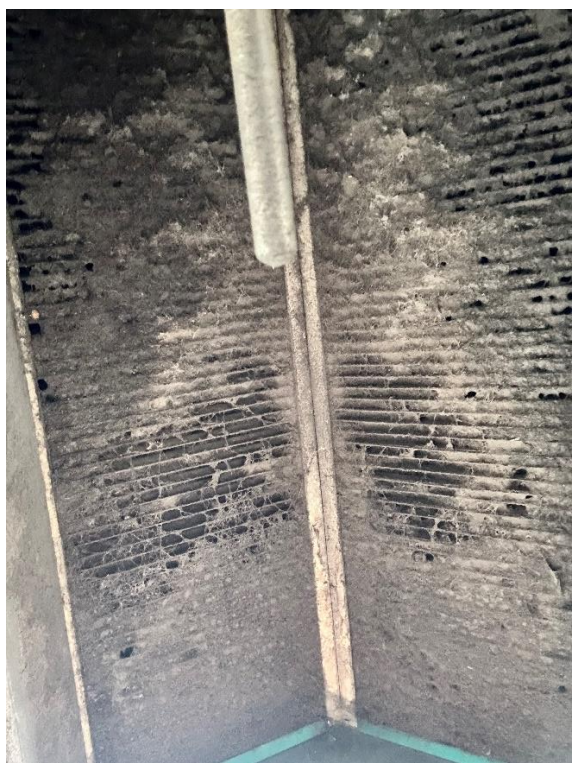
Fig. 7 Vervuilde aanzuig warmtewisselaars
