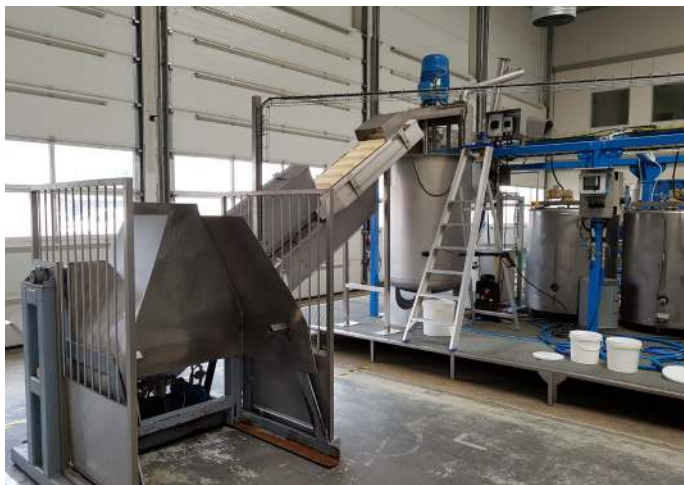
Figuur 2: Verwerkingsinstallatie ABC Kroos
